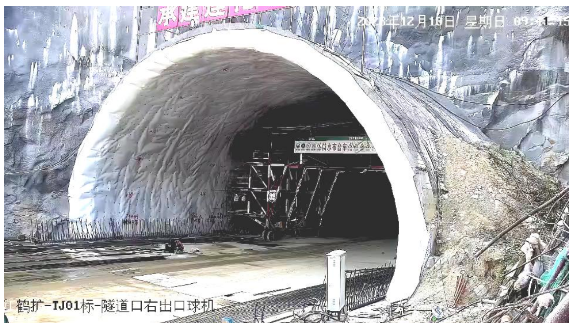
图 6 钢筋失稳过程
