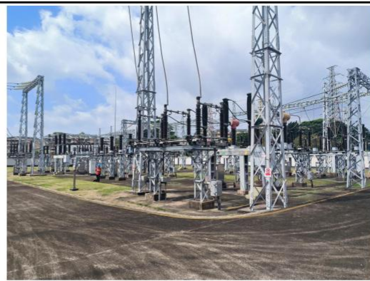
110kV 配电装置区
